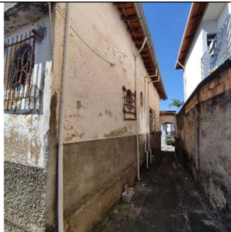
Foto 2: Vistas da fachada lateral direita da edificação evidenciando danos na pintura. Alex Alves Pereira, 17 jul. 2025.
