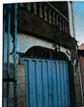
Foto 04- Portão de garagem Município de Caranaíba – MG.
