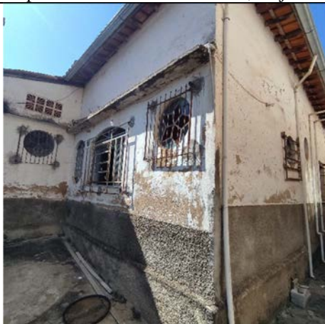
Foto 5: Sem intervenções de conservação preventiva, local possui progressão das patologias já evidenciadas. Alex Alves Pereira, 17 jul. 2025.
