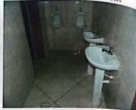
Foto 4. Instalação sanitária na edificação. Município de Caranaíba/MG Michelle Xavier Correia, Junho/2018
