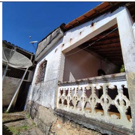
Foto 4: Vista da fachada posterior, evidenciando pontos de umidade ascendente na edificação. Alex Alves Pereira, 17 jul. 2025.
