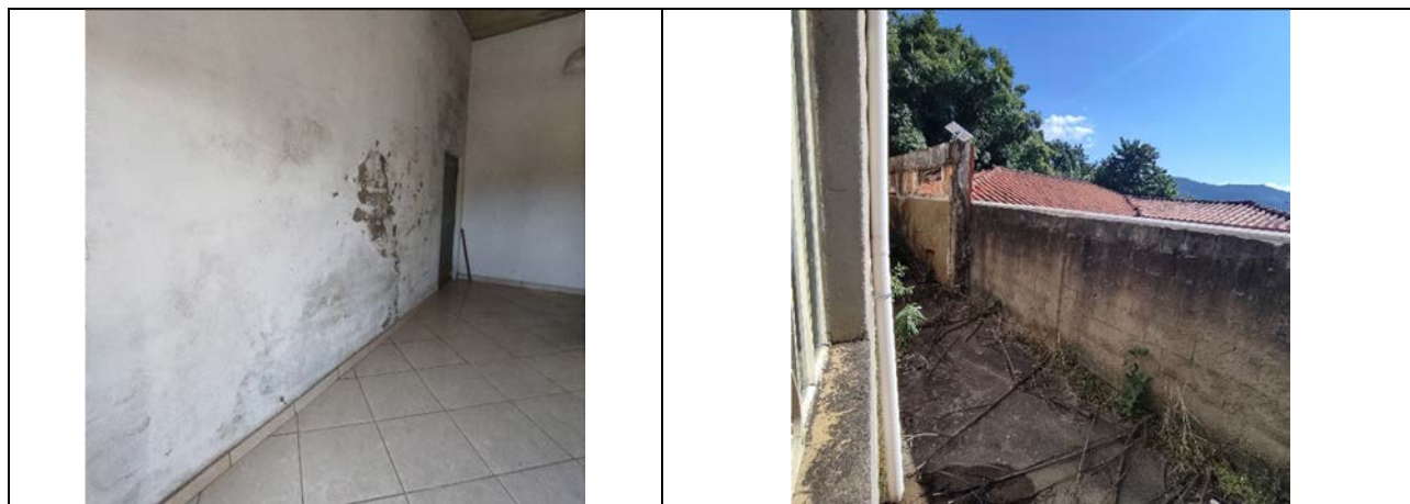
Foto 7: Em alguns pontos observa-se descascamentos e manchas de umidade nos revestimentos internos. Alex Alves Pereira, 17 jul. 2025.
