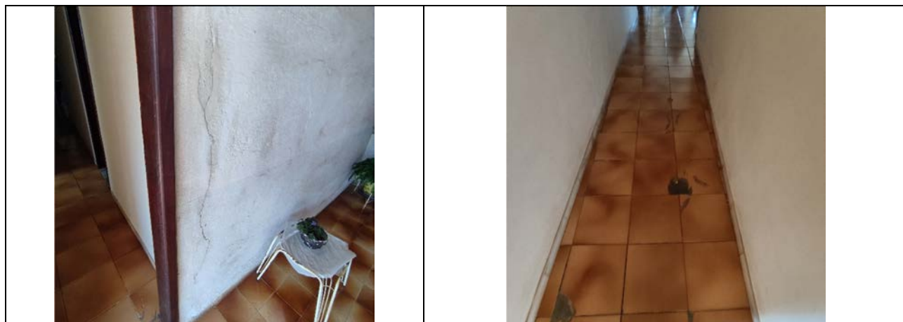
Foto 7: Alvenarias internas possuem pontos de fissuras e trincas. Alex Alves Pereira, 17 jul. 2025.
